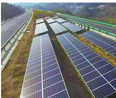
道路空地分布式光伏电站
